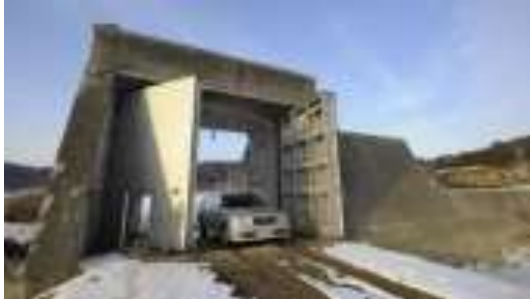
図-3 倒壊した第2防潮堤にあったゲート
