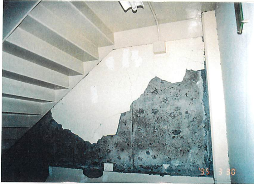
図4.9 階段室壁面の損傷の例
