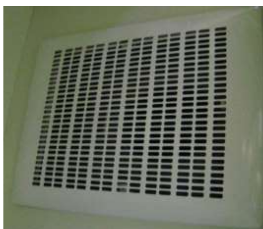
図 3.3 噴霧室換気扇 吹込口
