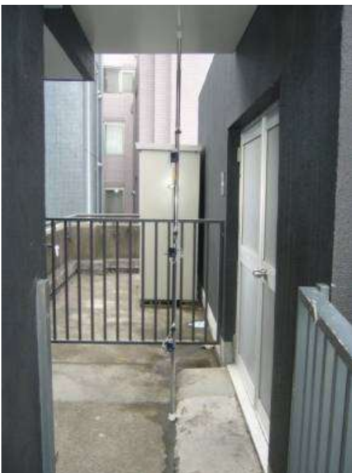
計測器の設置状況
