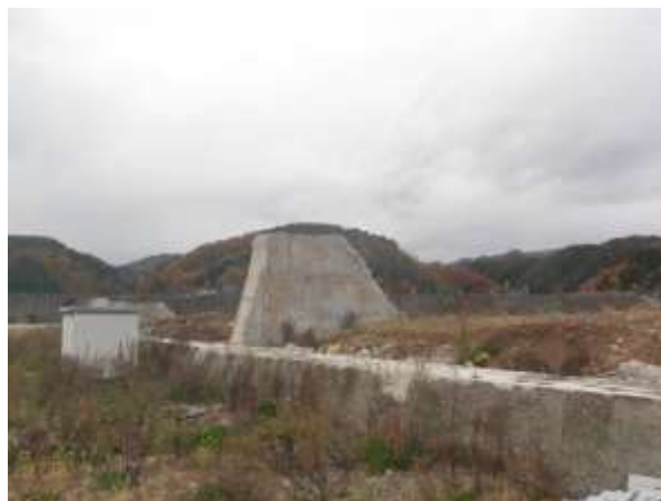
写真 - 4-1 第2防潮堤崩壊後（平成24年11月22日）
