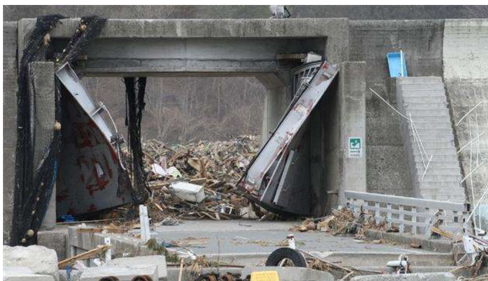
図-3-2-3 引き波により開いたゲート
