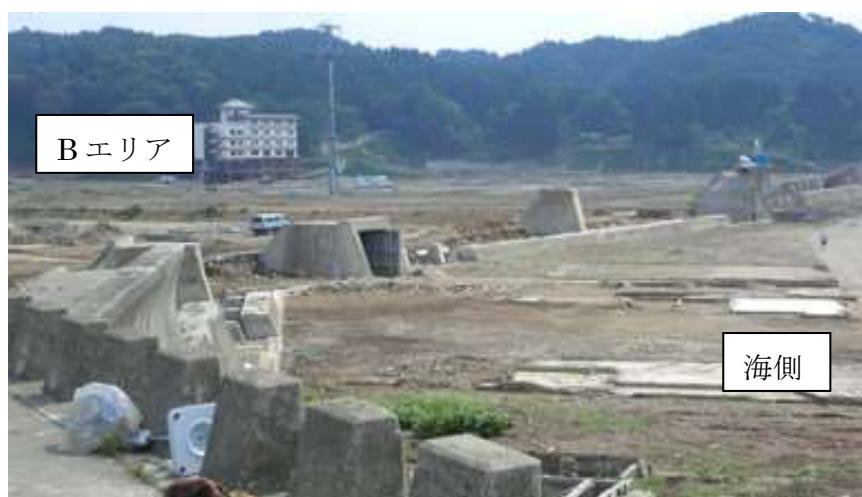
図-3-2-3 倒壊した第2防潮堤
