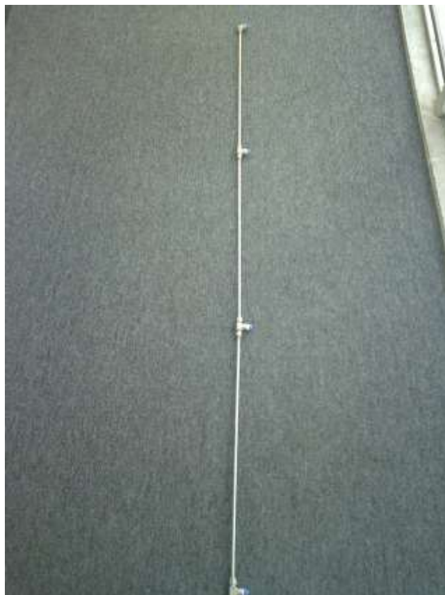
<図 9. Swagelok 社製配管を利用した直列型ノズル配管>
