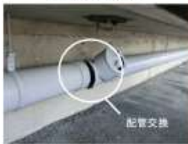
【雨水配管破損】
