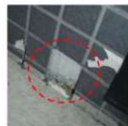
PF浅草駒形 外壁タイルの剥離
