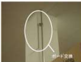
【柱耐火ボード破損】
