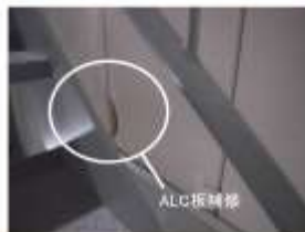
【屋内非常階段間仕切り板破損】
