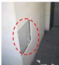
PU長町一丁目 共用部タイルの剥落
