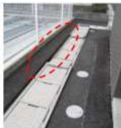
PU八乙女中央 外構の破損
