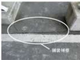
【アスファルト舗装ひび割れ】
