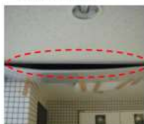
US日本橋横山町 エクスパンションジョイントの破損
