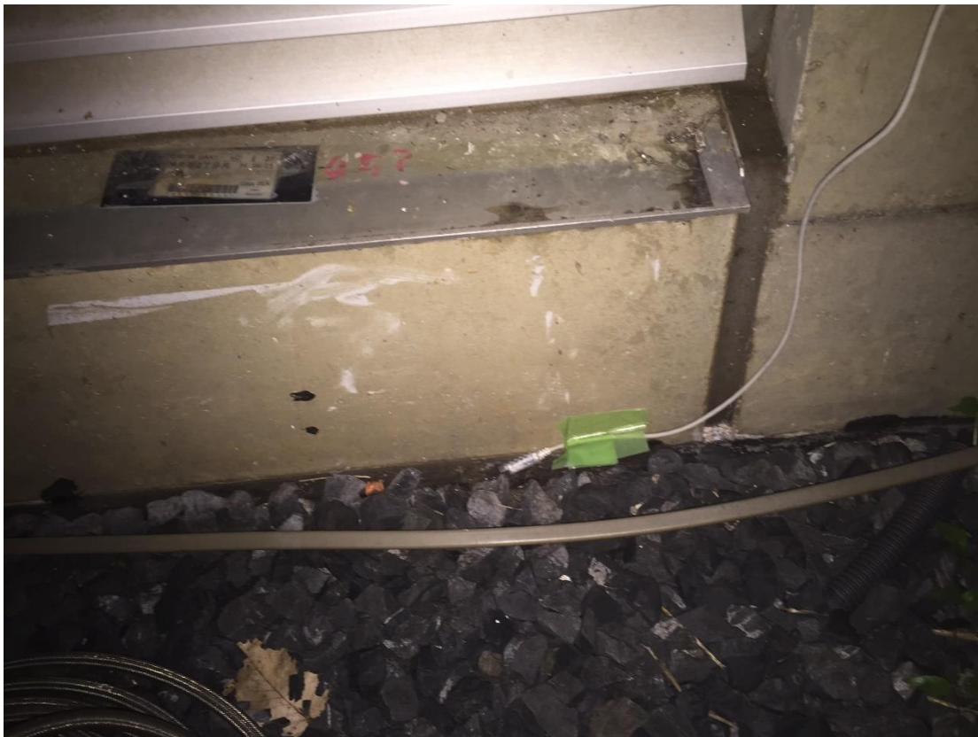
<図 10. ポルタ裏ミスト制御機の様子 2(ポルタ制御盤横ダクト GL0m)>
