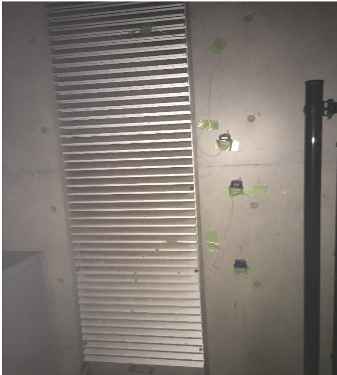
<図 9. ポルタ裏ミスト制御機の様子 1(ポルタ制御盤横ダクト)>
