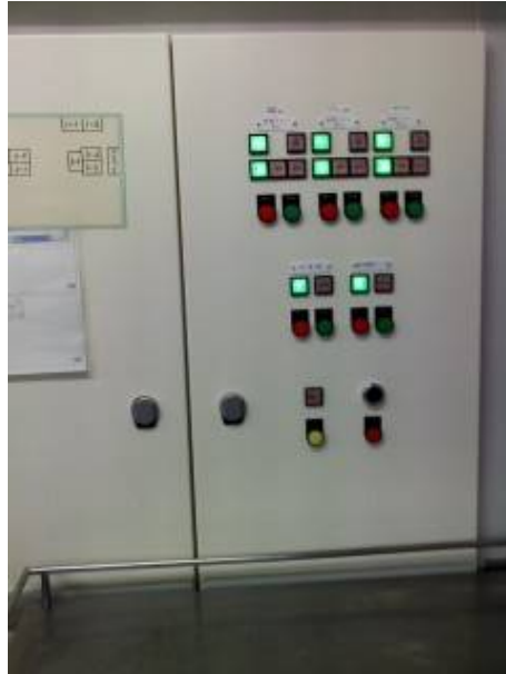
図3. 12 換気設備制御盤
