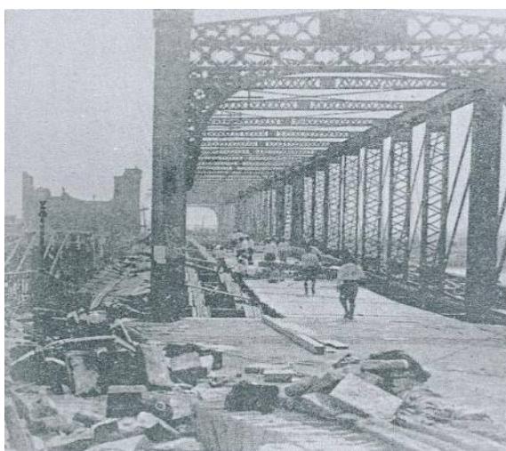
写真4 吾妻橋（木製床板が焼け落ち、臨時に角材を張り応急措置を行っている）
