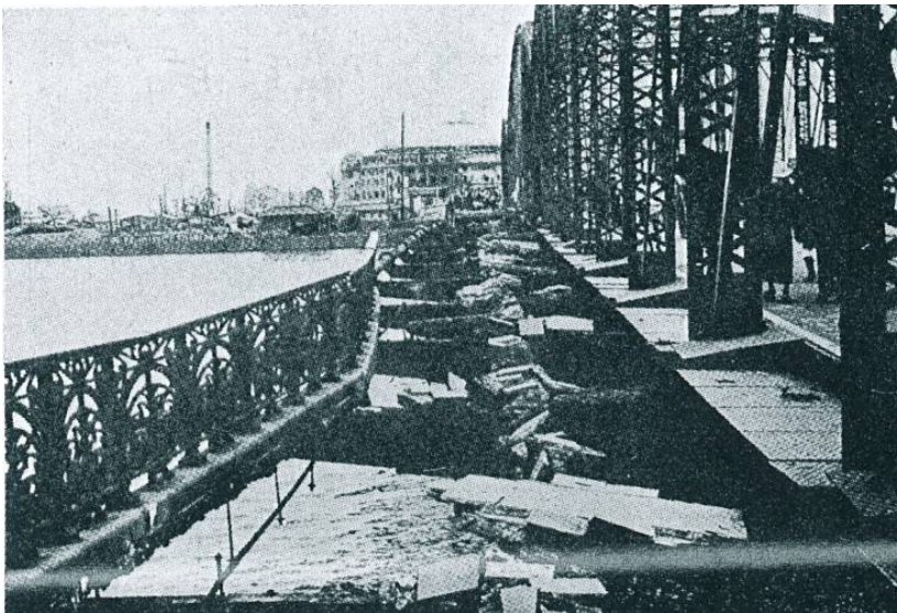
写真3 両国橋（上流側歩道が焼け落ちた状況）
