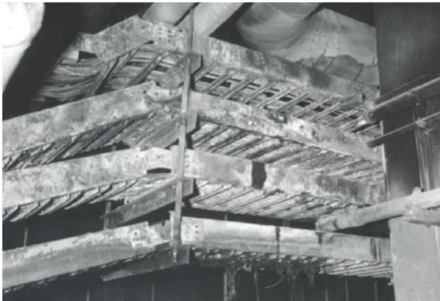
図7 ケーブル貫通部の火災後の様子（出典：原発の安全上欠陥）
